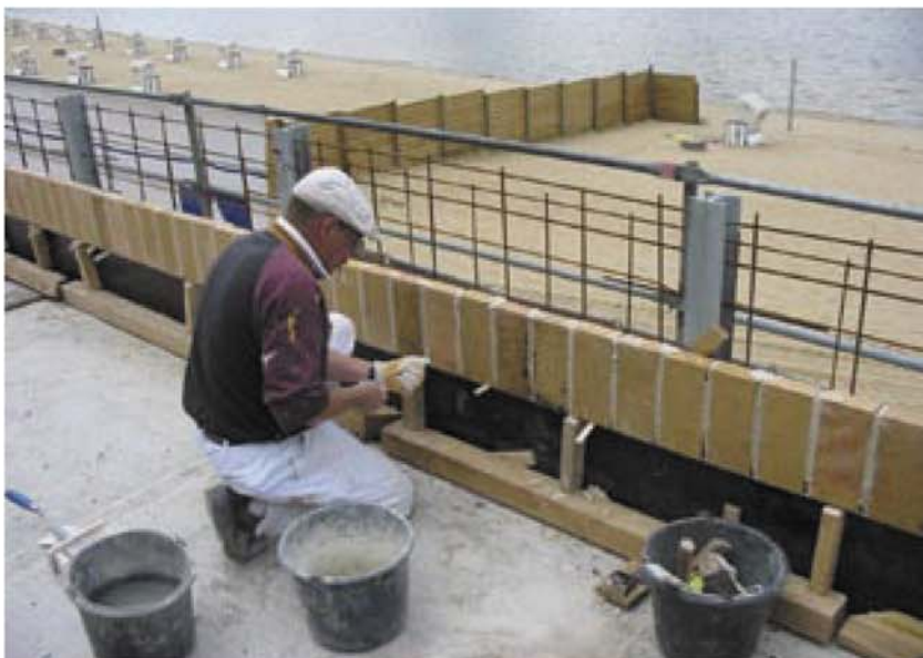
Die Sanierung des Strandbades soll bis zur Hundertjahrfeier im kommenden Jahr abgeschlossen werden. Fotos: Stiftung Denkmalschutz Berlin
