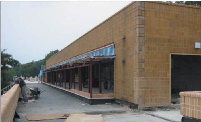
Das Sichtmauerwerk soll erhalten bleiben, die Stahlkonstruktion ist aber zu sanieren
