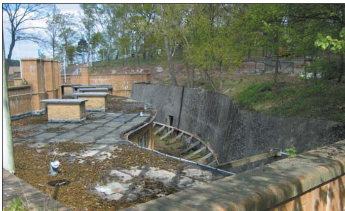
Strandbad Wannsee - bleibt das Restaurant künftig eine Ruine ?
