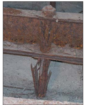
Die angerostete Hängekonstruktion zerblättert.
