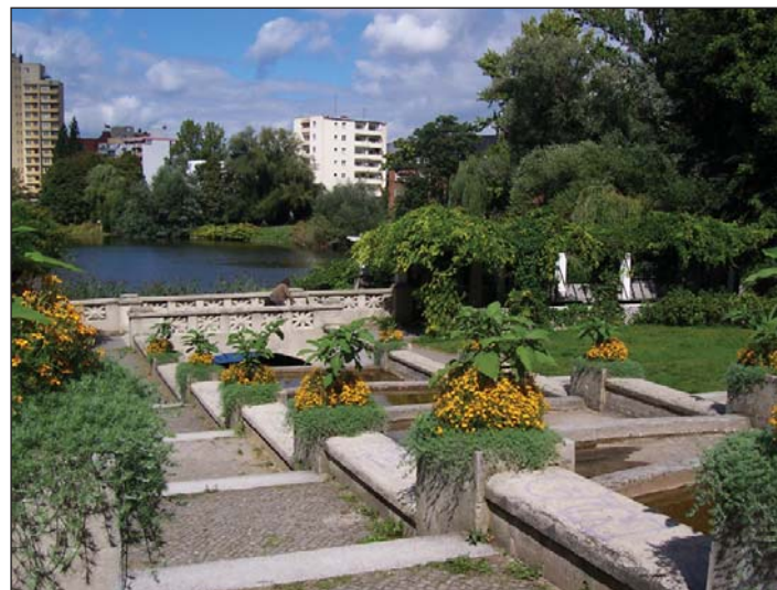
Die Lietzenseekaskade im heutigen Zustand. Die Idylle trägt, denn die baulichen Anlagen weisen erhebliche offene und verdeckte Schäden auf.
