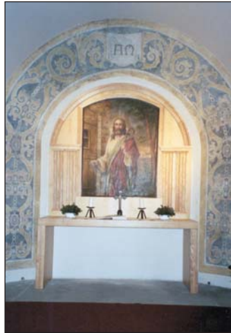
Der wiederhergestellte Altaraufbau, der das Altarbild und die ornamentalen Malereien wieder zur Einheit bringt.
