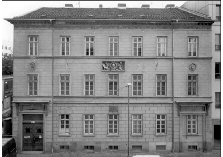
Das Schadow-Haus in der Schadowstraße. Die Fassade läßt bereits in Gestalt der Mauerwerksrisse den Sanierungsbedarf ahnen, die Restaurierung der Innenräume kommt hinzu - insgesamt eine herausragende Aufgabe für die Bundesrepublik.
