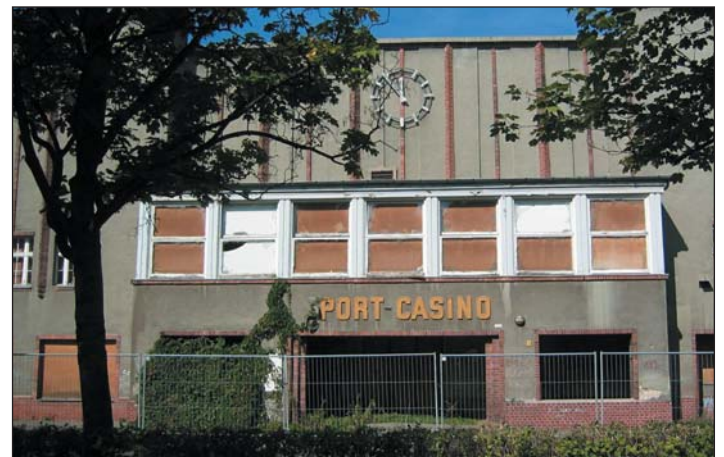
Die heruntergekommene Hauptfassade des Tribünengebäudes.
