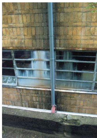
Verstopfte Rohre lassen das Wasser über die Maueroberflächen rinnen.
