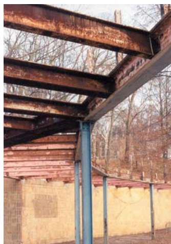
Die Stahlkonstruktion rostet.
