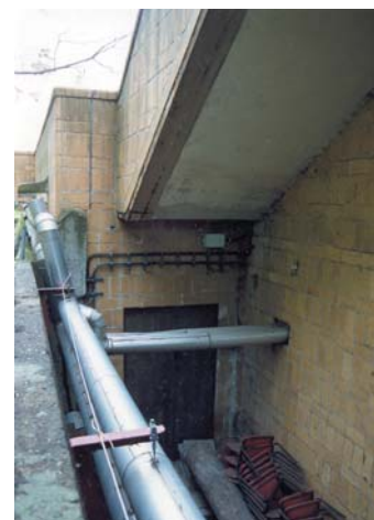
Wilde Versorgungsleitungen und Gerümpel - ein schöner Anblick?.
